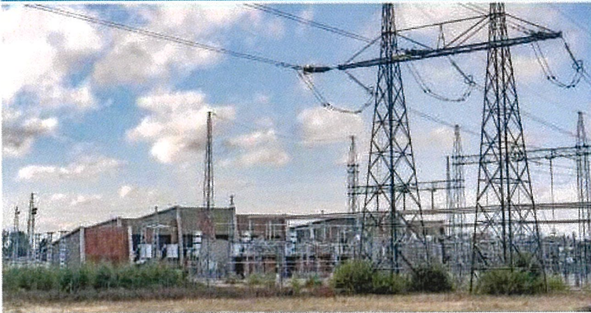
Den gigantiska omriktarstationen utanför Lyby är slutpunkten för den södra delen av Sydvästlänken mellan Närke och Skåne.
